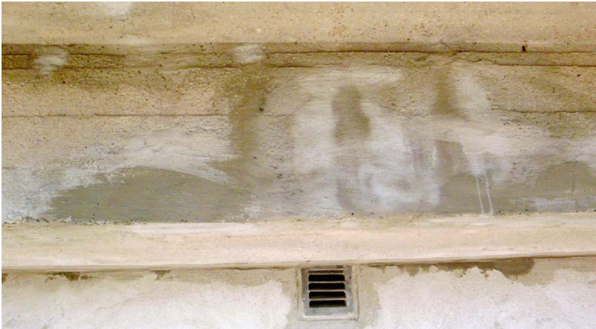
Foto 48 Betooni kohtparandused Kadrioru staadioni tribüünil Autori foto, 2009
