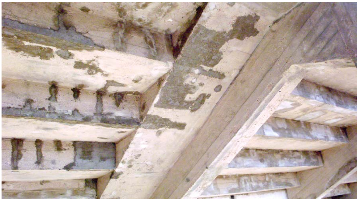
Foto 47 Betooni kohtparandused Kadrioru staadioni tribüünil Autori foto, 2009
