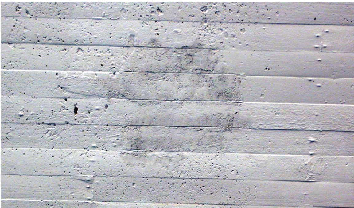
Foto 49 Betooni kohtparandused Kadrioru staadioni tribüünil Autori foto, 2009
